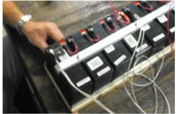
Figura 5: Montaje de las baterías en serie de 12 V 7.2 A/H
