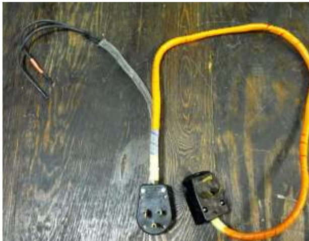
Figura 3: Cableados de conexión
